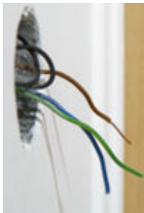
Açıkta kalan elektrik telleri.
